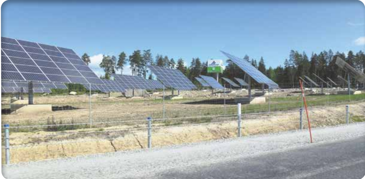
Solparken utanför Västerås.
